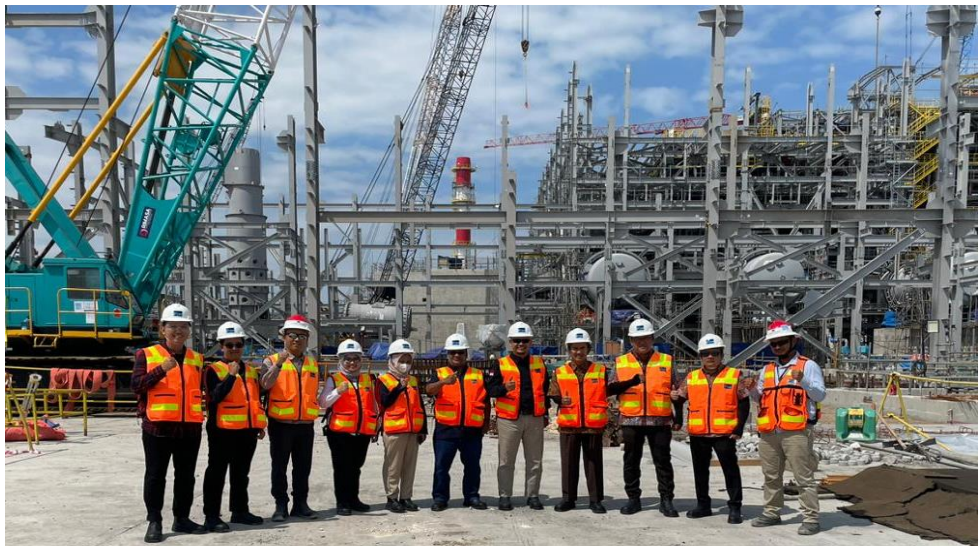
Gambar 3.4. Peninjauan Lapangan Pembangunan Smelter Tembaga PT Freeport Indonesia di Gresik, Jawa Timur
